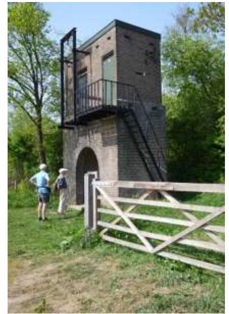
Een transformatorhuisje, uit 1926, is door bouw op een poort beschermd tegen hoogwater
